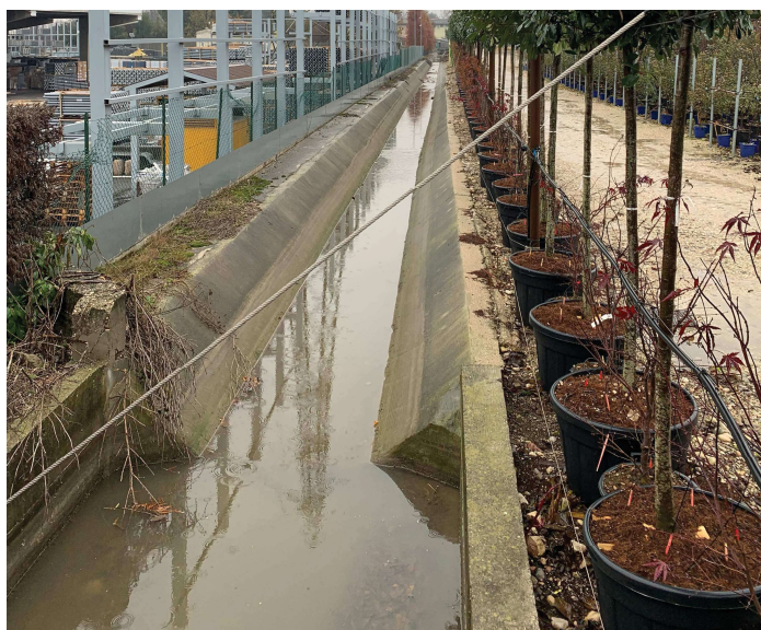
Fig.14-Comizio 3° e 4° nel tratto attiguo al vivaio prima del tratto Sifonato; canaletta 1500x1100 mm
