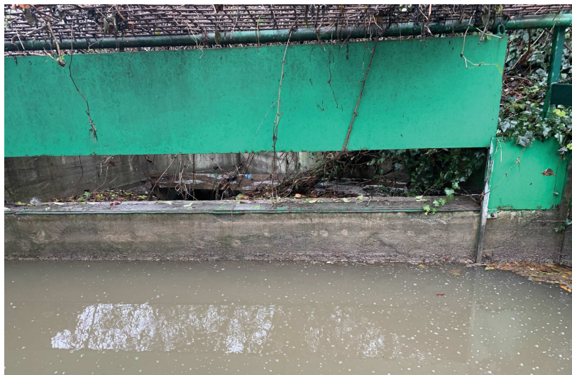
Fig.16 - Scaricatore di piena Comizio 3° e 4° posto a monte del tratto sifonato
