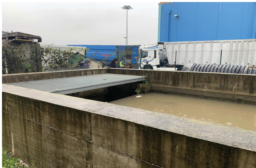
Fig.25-Foto n.4- Manufatto ripartitore di portata presente all'interno della proprietà Feralpi S.p.A
