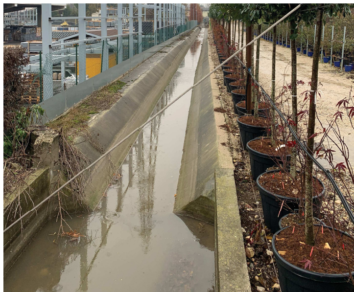
Fig.14-Foto n.1- Comizio 3° e 4° nel tratto attiguo al vivaio prima del tratto Sifonato; canaletta 1500x1100 mm
