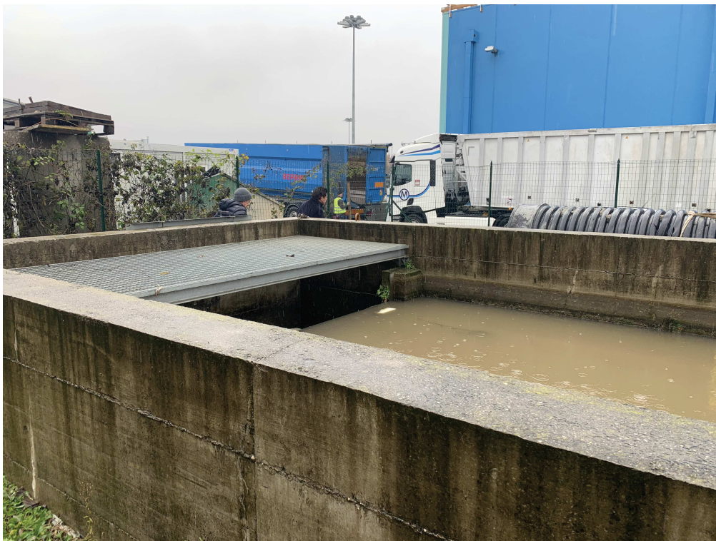
Fig.25-Foto n.4- Manufatto ripartitore di portata presente all'interno della proprietà Feralpi S.p.A
